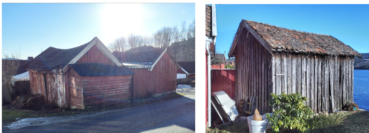
Figur 5-1: Eksempler på truede bygninger med varierende grad av forfall. Paradokset er at bygninger som er lite endret og dårlig vedlikeholdt, ofte har høy grad av autentisitet. Kilde: Asplan Viak
