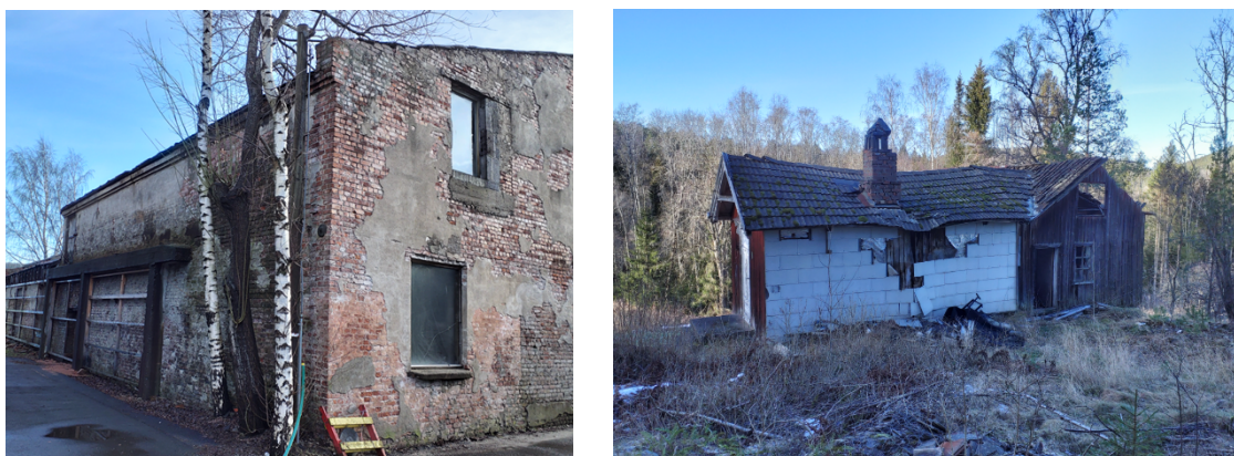
Figur 5-2: Eksempel på to bygninger som ligger i grenselandet mellom sterkt truet og tapt. Kilde: Asplan Viak
